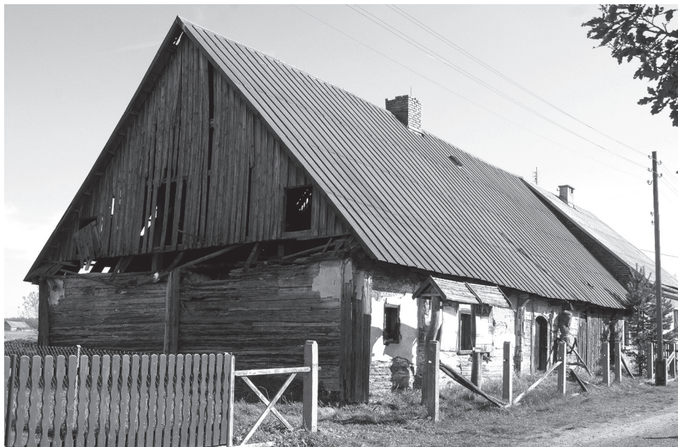
FIG. 4. XIX-wieczny budynek mieszkalny uznawany dawniej za obiekt wchodzący w skład XVIII-wiecznej fabryki fajek (© B. Grabny).
