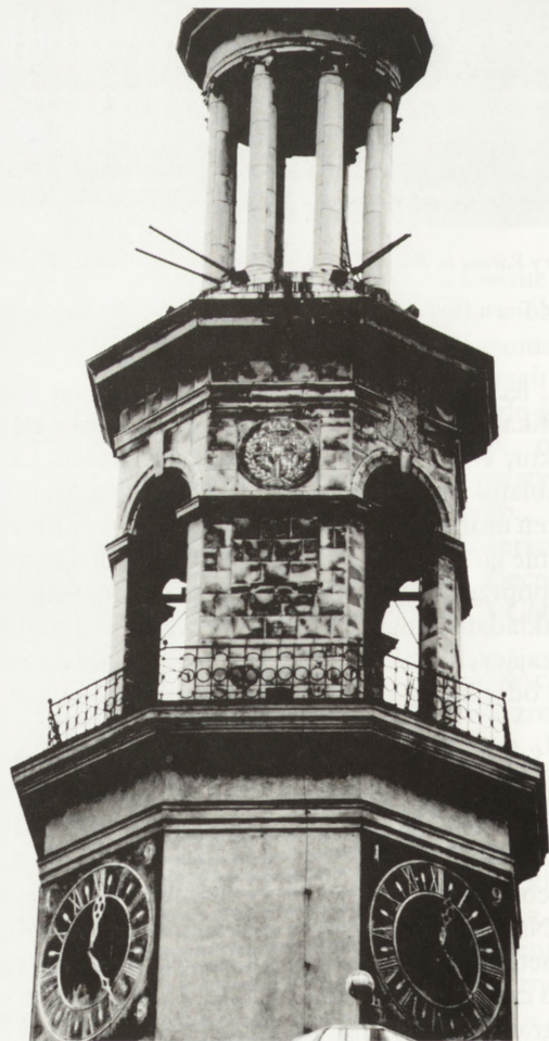
5. Latarnia. Nawarstwienia na blasze miedzianej. Stan zachowania w 1993 r.
