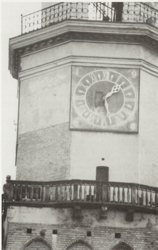
4. Wieża. Widoczne ubytki tynku, zamakanie partii tynku pod balustradą. Stan zachowania w 1993 r.
