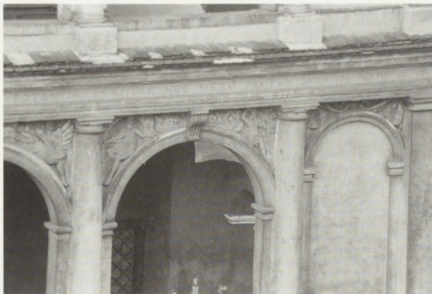
3. Stary Ratusz w Poznaniu — loggia parteru. Widoczne ubytki tynków, nawarstwienia, zamakanie z uszkodzonej instalacji odwodnieniowej. Stan zachowania w 1993 r.
