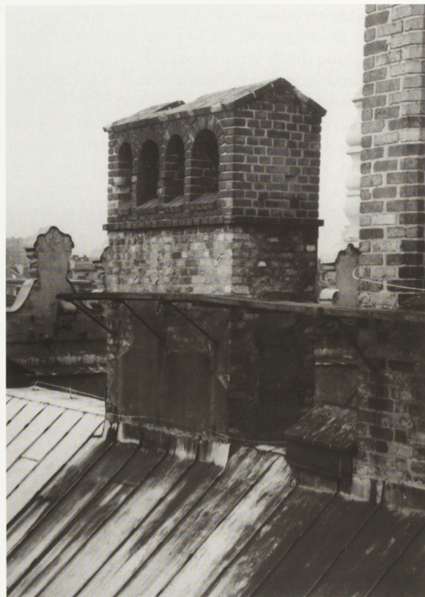
7. Stary Ratusz w Poznaniu. Komin kotłowni węglowej. Widoczne zniszczenia cegły, tynku i blach. Stan w 1993 r.
