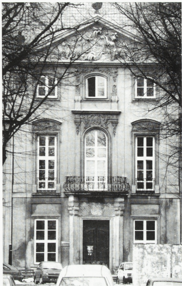
9. Warszawa, Pałac Czapskich — aktualny wygląd tej samej części budynku, po wymianie stolarki
