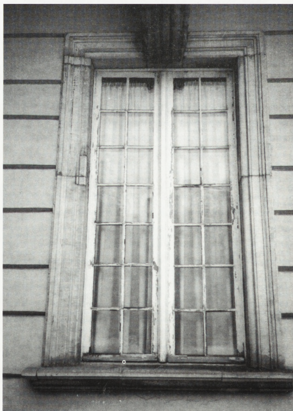
30. Warszawski Zamek Królewski — zniszczona stolarka okienna w parterze budynku od strony dziedzińca zamkowego
