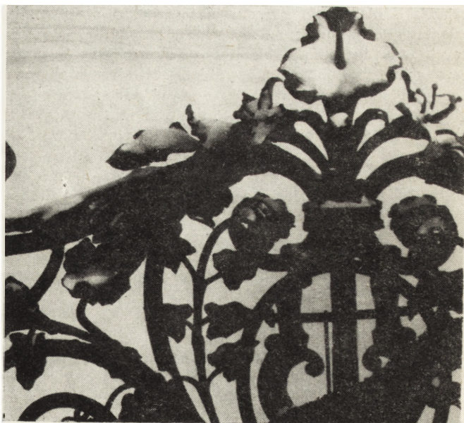
Kute, stalowe elementy ogrodzeń o silnie rozwiniętej powierzchni; dokładne oczyszczenie takich elementów z produktów korozji jest prawie niemożliwe (fot. W. P. Jabłoński)
