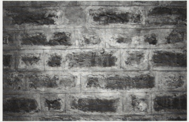
9. Przykład konserwacji muru ceglanoego metodami budowlanymi z pominięciem elementarnych zasad konserwatorskich — przeczyszczanie mechaniczne powierzchni cegły, zatarcie spoin i wyprowadzenie ich w formie rytých zagłębieni. Wrocław, katedra, Kaplica Najświętszego Sakramentu, fragment ściany zewnętrznej. Fot. J. Lewicki 1999
