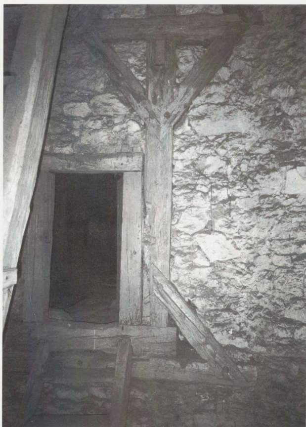
10. Ściana szczytowa (zachodnia) z widocznym wzmocnieniem drewnianą konstrukcją ryglowo-zastrzałową i otworem drzwiowym prowadzącym na poddasze, 1999 r. Fot. P. S. Szlezynger
