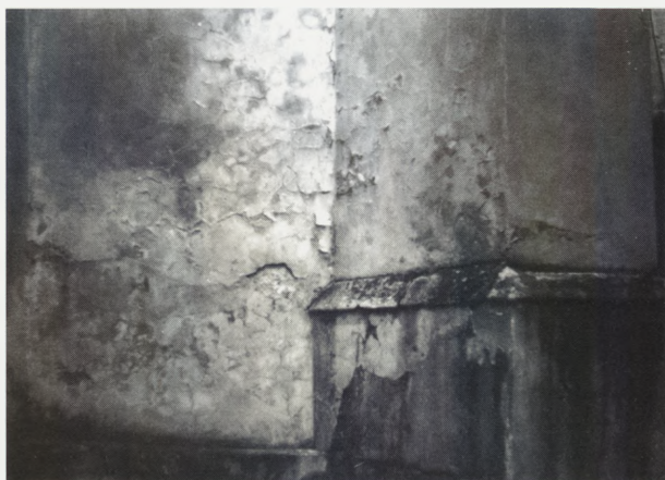
4. Przypory nawy od południa, 1999 r. Czytelne odparzenia i ubytki tynków spowodowane zawilgoceniem murów w przyziemiu. Fot. P. S. Szlezynger
