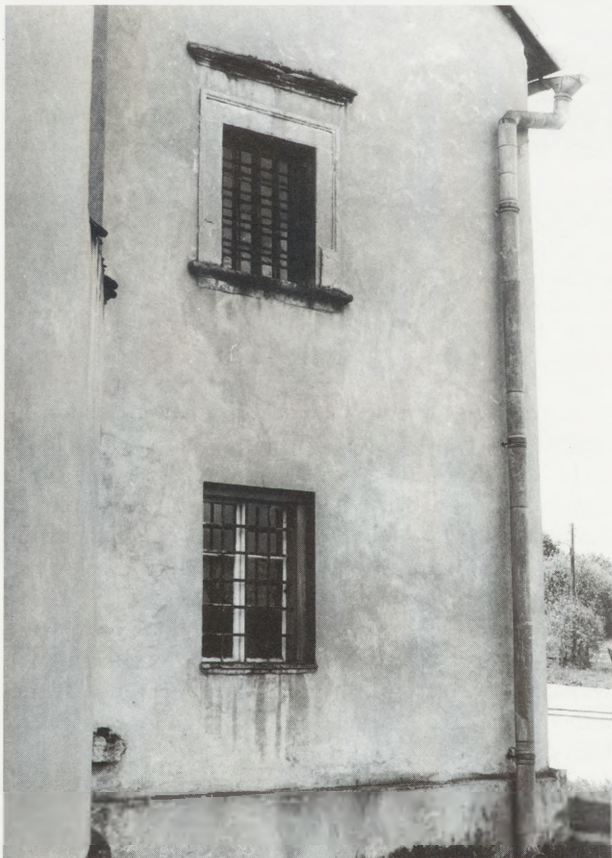
5. Zakrystia i skarbczyk kościoła, widoczne rozwarstwienia odparzonych tynków i wykruszenia kamieniarki okien, widok od wschodu. Fot. P. S. Szlezzynger
