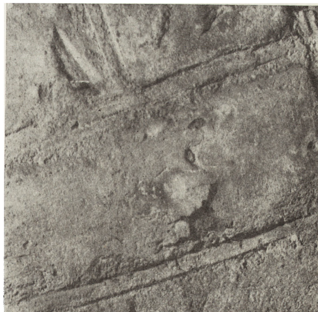
3. Gniezno, kościół Sw. Jana, dezintegracja powierzchniowej warstwy cegły, stan z 1978 r.
