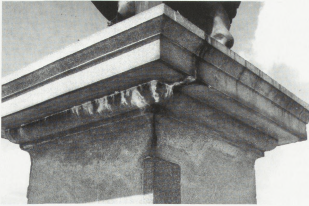
19. Gzyms podstawy posągu kolumny pokryty solami wydobywającymi się z cementu, przed konserwacją. Fot. P. Mastalerz, 1996
