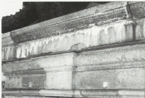
16. Gzyms piedestału pokryty solami wydobywającymi się z cementu. Fot. J. Mróz, 1994
