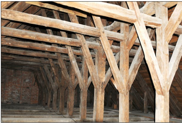
Ryc. 2. Widok na więźbę dachową nad nawą główną, rok 2020. Fig. 2. View of the roof truss above the main nave, 2020.
