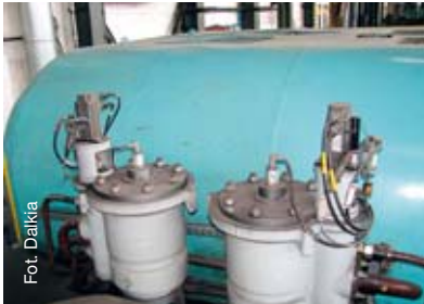
Rys. 1. Zabudowa siłowników Exlar na serwomotorach zaworów regulacyjnych turbiny
