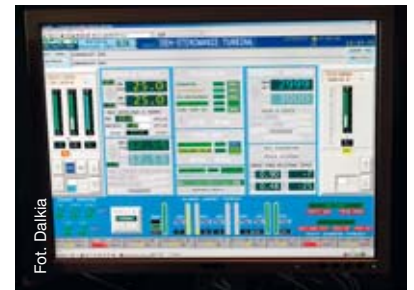
Rys. 3. Jeden z obrazów synoptycznych wykorzystywanych do prowadzenia rozruchu, regulacji i odstawiania turbiny
