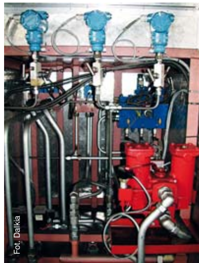
Rys. 2. Zabudowa bloku awaryjnego wyłączenia
