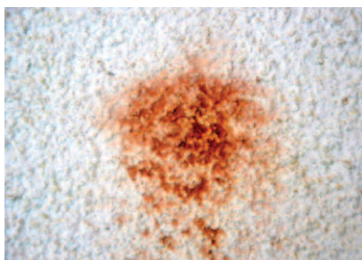
Photo 3. Rust color discoloration on the white ETICS plaster Fot. 3. Przebarwienie koloru rdzawego na białym tynku ETICS
