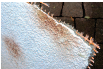
Photo 5. View of the break in the plaster-reinforced layer system; with rust-colored discolorations visible on the plaster surface Fot. 5. Widok przelomu układu tynk-warstwa zbrojąca; na powierzchni tynku widoczne przebarwienia koloru rdzawego
