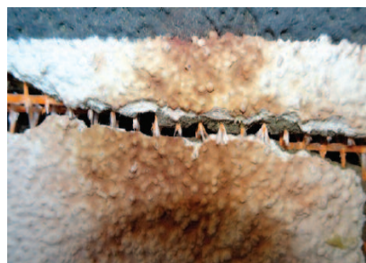
Photo 4. Close-up of the rust-colored discoloration on the white ETICS plaster Fot. 4. Zbliżenie na przebarwienie koloru rdzawego na białym tynku ETICS
