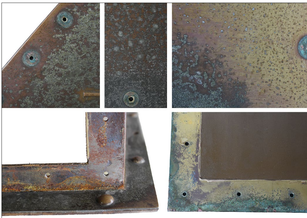
Ryc. 6. Skupiska wżerów i produkty korozji na mosiężnych blachach i stalowej konstrukcji sarkofagu; fot. T. Trzos
