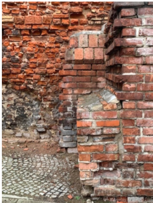
Rys. 6. Ubytki w cegle oraz stan zanieczyszczenia murów od strony ulicy Latarnianej [opracowanie własne]
