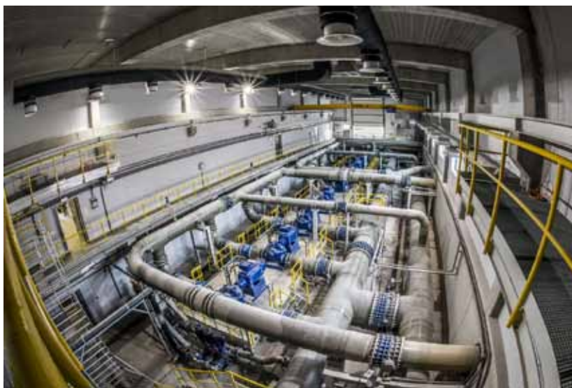
Rys. 2. Hala pomp wody uzupełniającej
