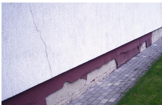
Rys. 4. Destrukcja okładziny cokołów – budynek szkolny w województwie lubelskim
