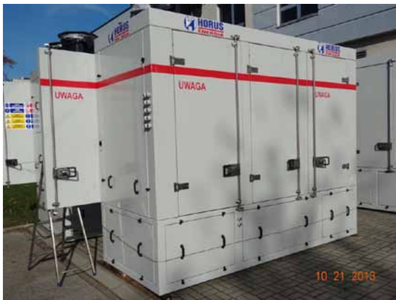
Rys. 4. Agregat prądowłórczy w trakcie uzbrajania w elementy elektronicznie sterowanego systemu zasilania poprodukcyjnymi paliwami gazowymi przed budynkiem Laboratorium Silników Politechniki Krakowskiej
