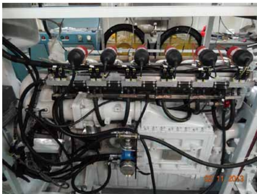
Rys. 5. Układ zapłonowy i układ zasilania gazami poprodukcyjnymi silnika 6-cylindrowego
