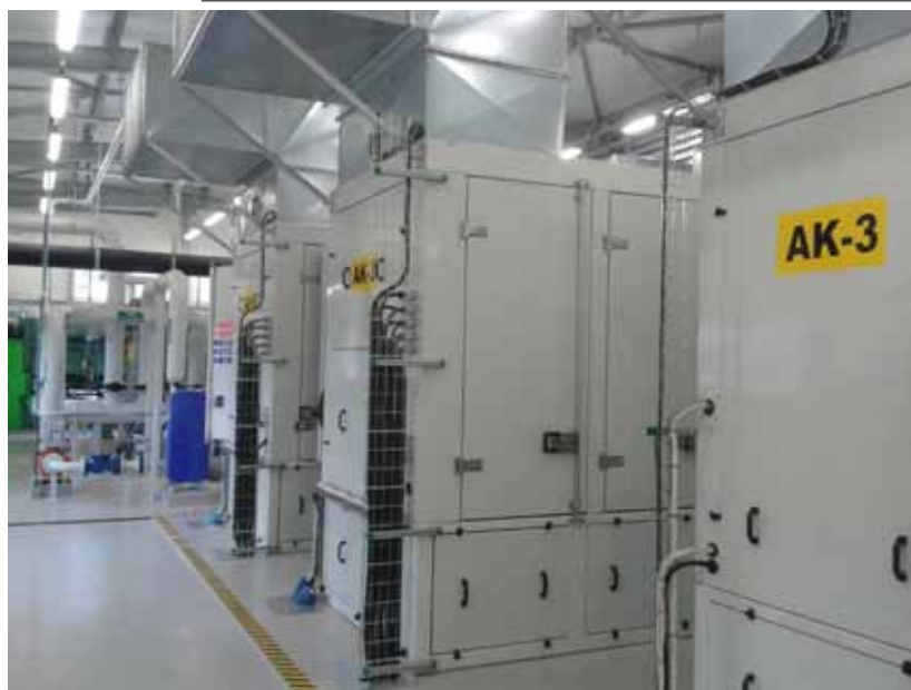
Rys. 8. Agregaty z elektronicznie sterowanym systemem wtrysku gazowych paliw poprodukcyjnych w obiekcie na terenie Zakładów Azotowych w Kędzierzynie-Koźlu
