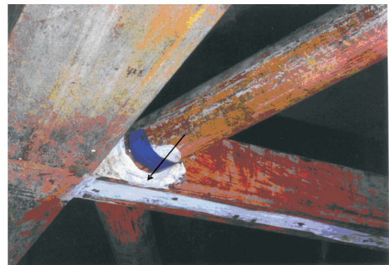
Rys. 4. Pęknięcie spiny zastrzału i poprzeczki masztu wiertnicy N12
