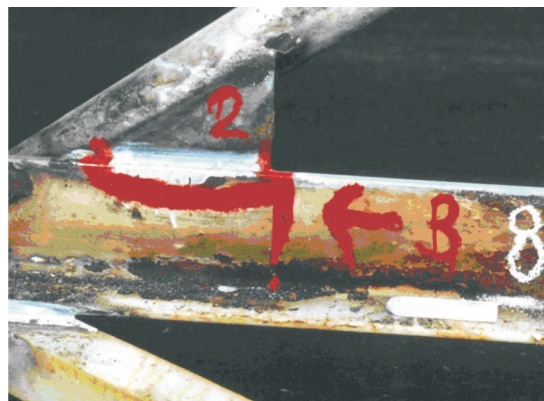
Rys. 7. Pęknięcie spiny narożnika i zastrzału masztu Skytop Brewster N4A
