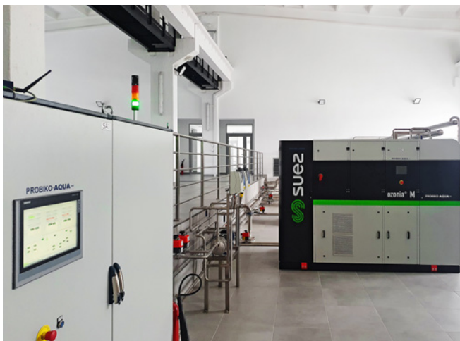
Panel sterowniczy i generator
