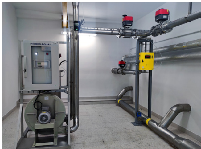
System destrukcji ozonu resztkowego
