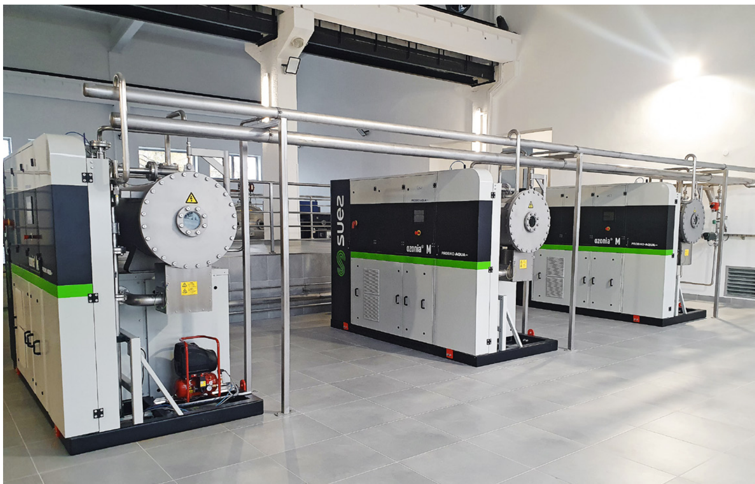
Hala ozonu po modernizacji, na pierwszym planie nowe generatory ozonu
