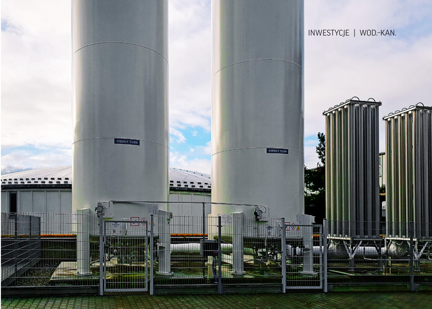
Zbiorniki i parownice tlenu
