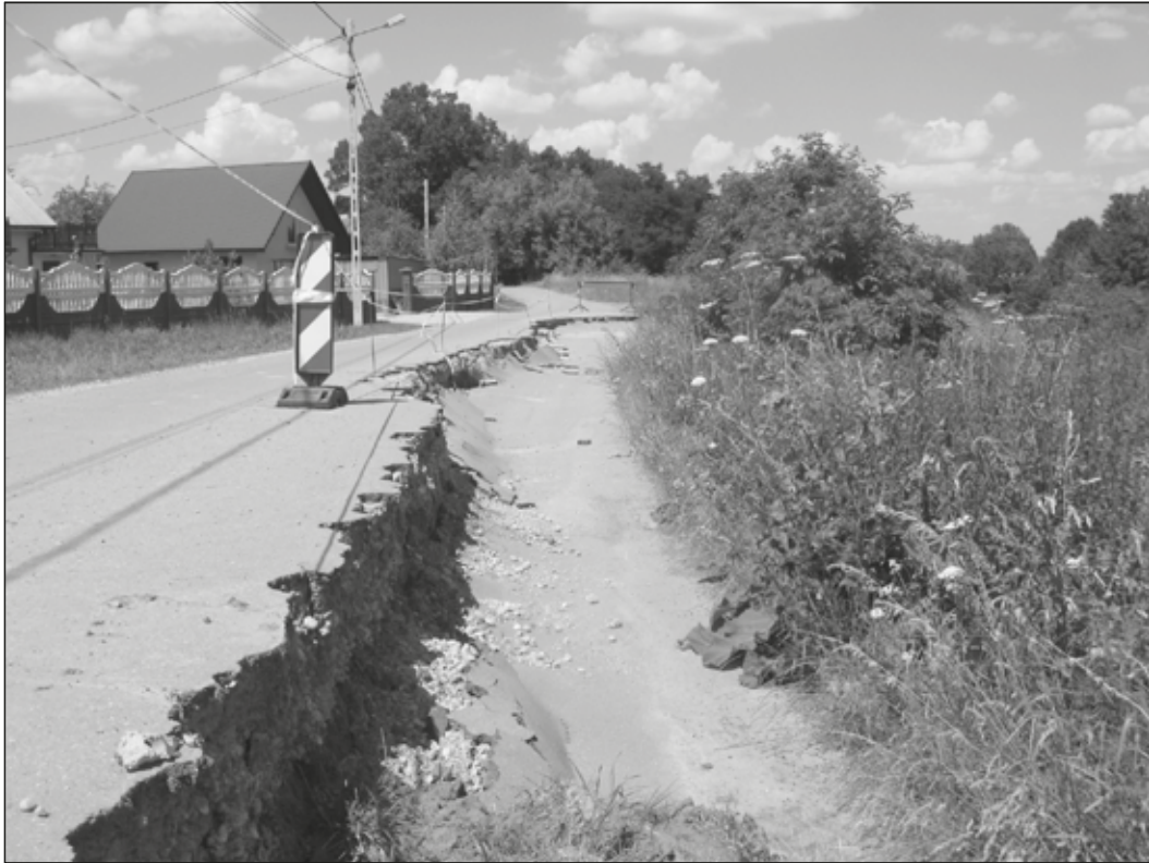
Fig. 21. Skarpa główna w obrębie uszkodzonej drogi – osuwisko Sadowie
