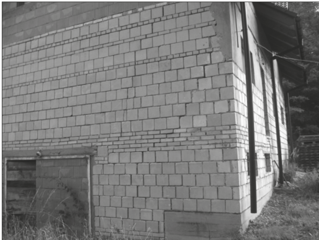
Fig. 15. Spękania budynku mieszkalnego na osuwisku w Ochojnie
