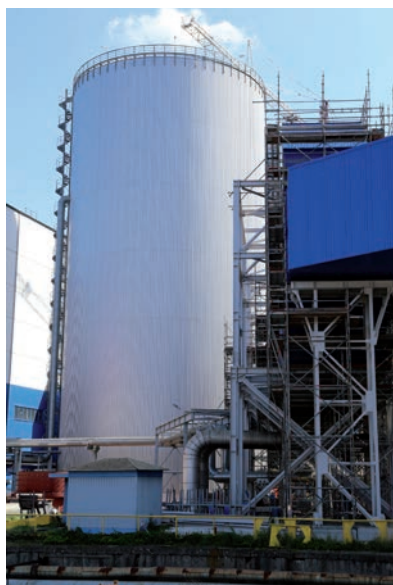
Fot. Akumulator ciepła
