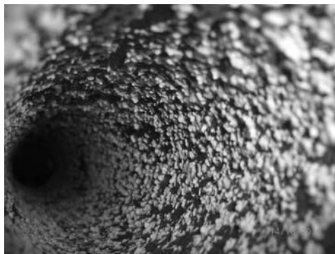
RYSUNEK 8. Fotografia rurociągu po zakończeniu cyklu 3 FIGURE 8. Photography of the pipeline after Cycle 3
