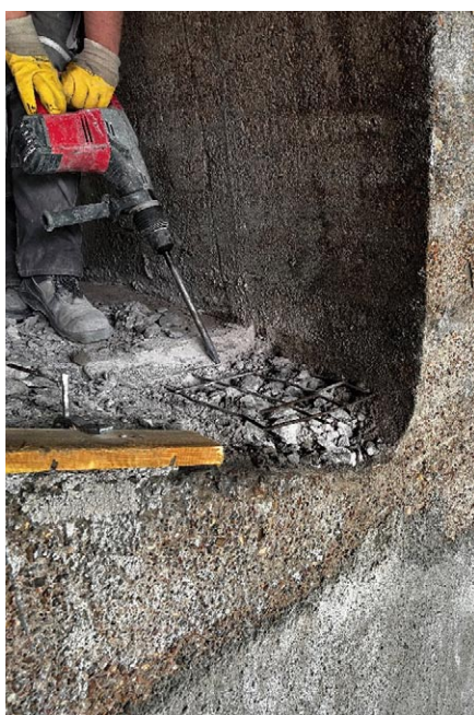
Rys. 6. Rozkuwanie odspojonego i zdegradowanego betonu, pozostałego po poprzednich naprawach obiektu zabytkowego (archiwum autora)
