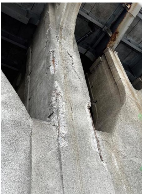
Rys. 5. Widok uszkodzeń żelbetonowej konstrukcji wsporczej zabytkowego wiaduktu (archiwum autora)
