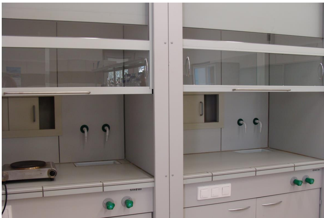
Fot. 3 Dygestorium w pracowni kontroli wód i ścieków Laboratorium (fot. A. Palczewska, WZU S.A., 04.2017 r.)
