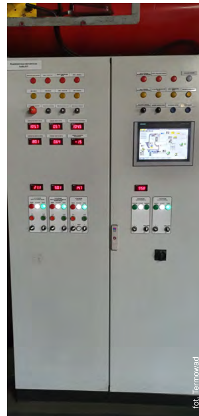
Nowa szafa sterownicza kotła WR-10 nr 1
