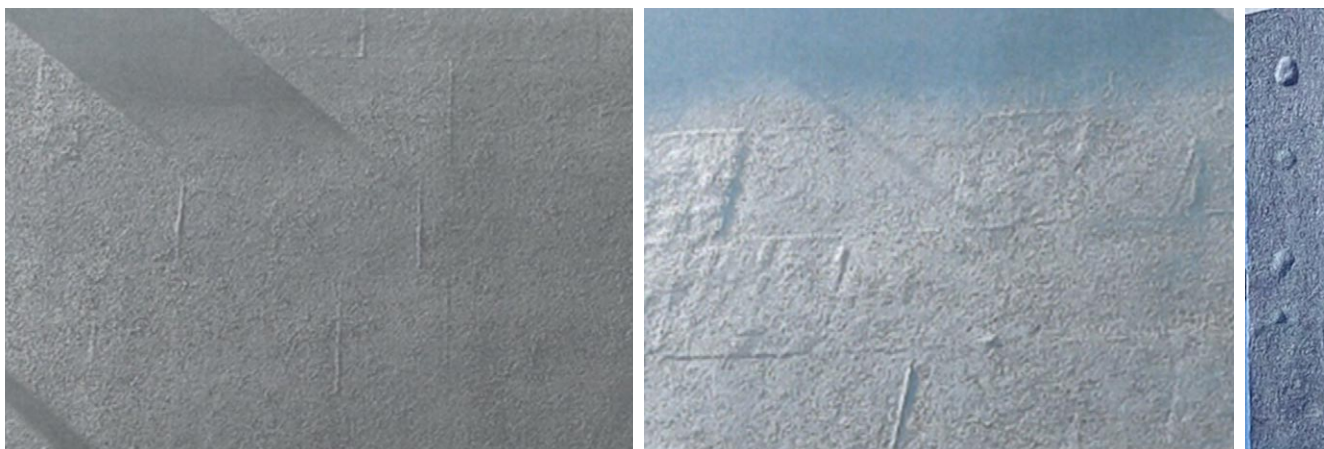
Rys. 1. Widok fragmentu elewacji budynku z ociepleniem ETICS ( TSR = 26 ) – nieprawidłowości w postaci wybrzuszeń i deformacji tynku w kolorze antracytowym [16]
