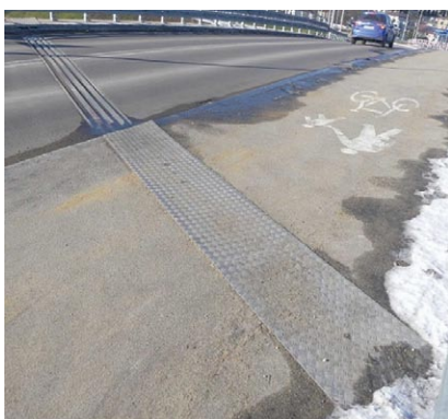
Rys. 6. Urządzenie dylatacyjne cztero-modułowe na przyczółku południowym po przebudowie mostu
