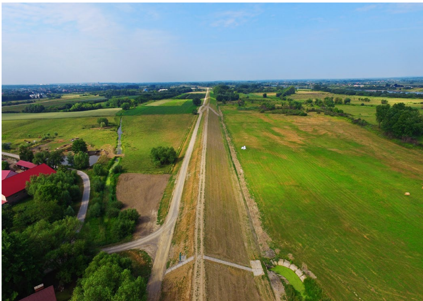
Rozbudowa prawego wału Wisły w km od 5 + 950 do 15 + 819 na odcinku od Tarnobrzega (Skalna Góra) do Koćmierzowa (granica województw podkarpackiego i świętokrzyskiego)
