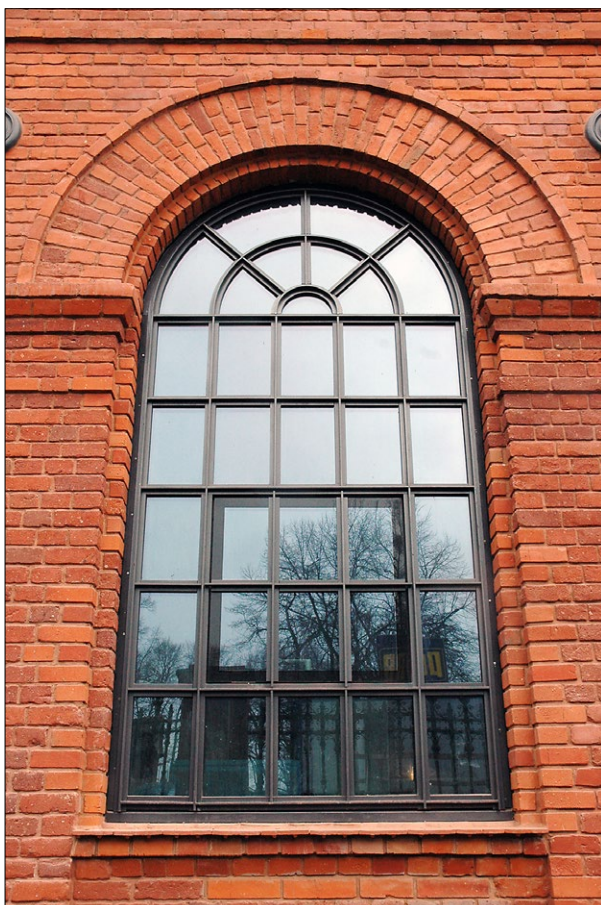
Ryc. 9. Dobry przykład współczesnej ślusarki okiennej odtwarzającej charakter dawnego okna fabrycznego w dawnej przędzalni Izraela Poznańskiego zaadaptowanej na potrzeby hotelu Andel's; fot. autor
