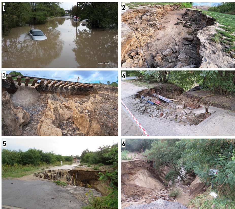
Rys. 9. Wybrane fotografie autorskie ukazujące zniszczenia w rejonie Gorzowa Wlkp. na skutek nawałnych opadów deszczu oraz zalaną ulicę Warszawską w lewym górnym rogu (źródło: 1 - TVN24, 2-4 - fot. Patryk Matczak, 5-6 - fot. Krzysztof Januszewski).
