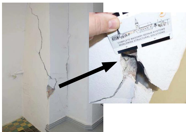
Rys. 5. Spękania komina w piwnicy – rozwarcie 30 mm
