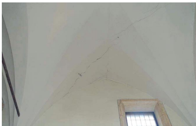
Rys. 7. Zarysowanie sklepienia w niskiej sieni – rozwarcie 1,0 mm
