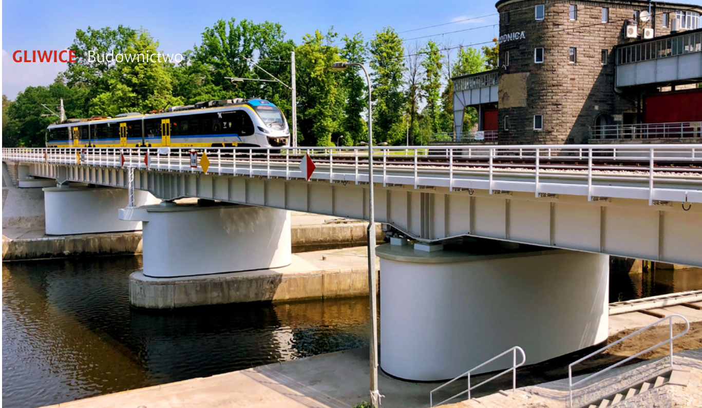
Przebudowa mostu kolejowego w km 2,528 linii kolejowej nr 136 Kędzierzyn-Koźle – Opole Groszowice przez Kanał Gliwicki, fot. Piotr Majchrzak; Nowak-Mosty Sp. z o.o.
