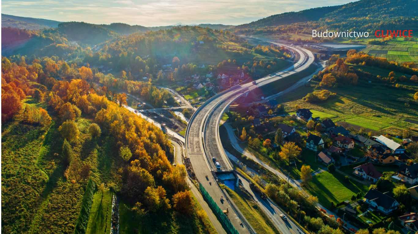
Budowa drogi ekspresowej S7 Kraków – Rabka-Zdrój na odcinku Lubień – Naprawa, od km ok. 713 + 580 do km ok. 721 + 170, fot. Stanisław Jabłoński, STAHADRON
