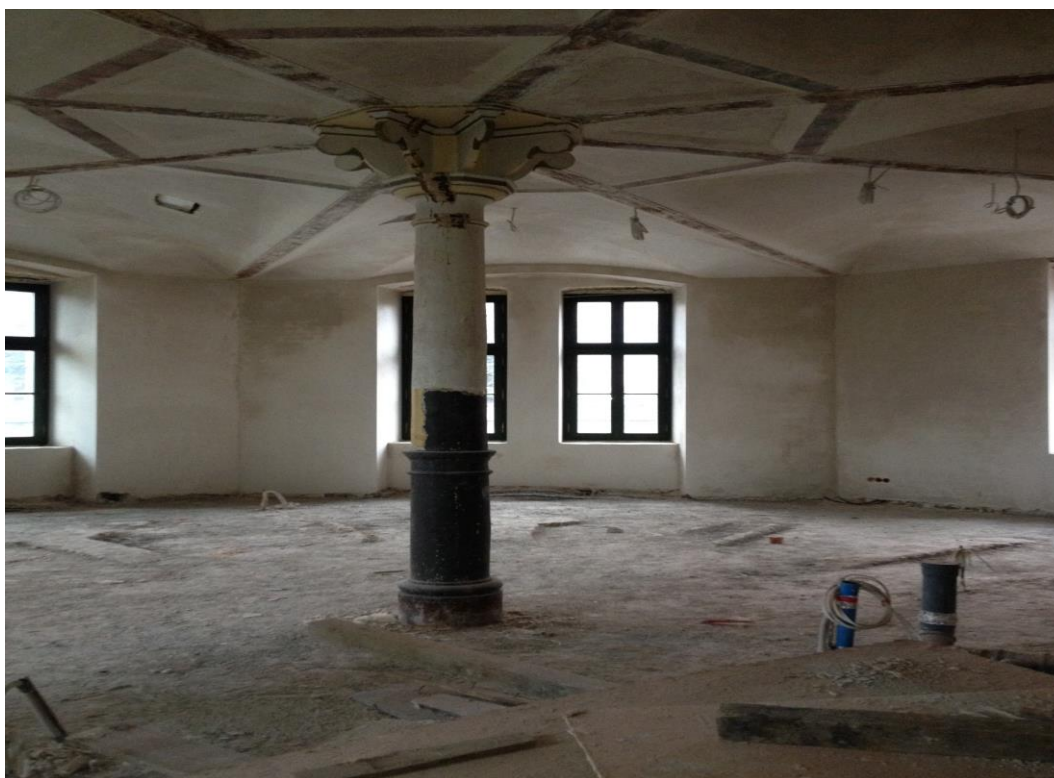
II.4. Sala z żeliwną kolumną w przyziemiu, stan obecny; (autor: Dominika Długosz)
