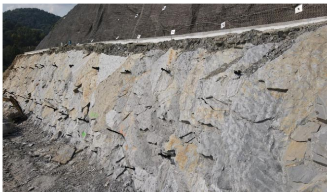
Rys. 4. Węzeł Milówka, ściana oporowa nr 1; równoległe powierzchnie laminacji piaskowca, kąt upadu warstw skalnych od 60 do 80°
