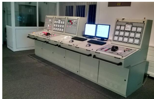
Rys. 2. Konsola sterująca silnika napędu głównego statku i elementów pomocniczych
