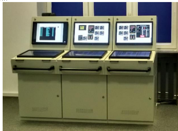
Rys. 4. Stanowisko Centrali Manewrowo Kontrolnej realizowane na sześciu ekranach dotykowych
