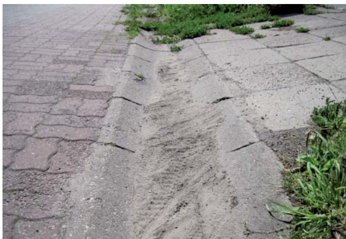
Fot. 7. Prefabrykowane, zbyt głębokie korytko ściekowe dodatkowo zanieczyszczone gruntem, utrudnia przejazd kołami wózka inwalidzkiego – Kołobrzeg (fot. K. Kasperczak)
