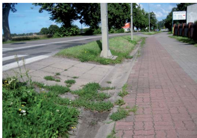
Fot. 6. Usytuowanie strefy oczekiwania na stromym pochyleniu stwarza niebezpieczeństwo przy wkraczaniu na jezdnię – Kołobrzeg (fot. K. Kasperczak)
