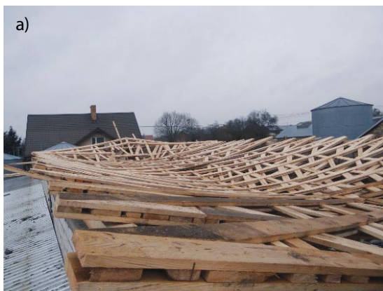
Rys. 1. Zniszczone dźwigary drewniane: a) brak elementów łączących dźwigary ze ścianami, b) zawalona ściana szczytowa
