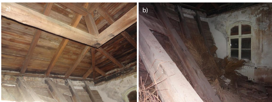
Rys. 4. Więźba dachowa: a) widok stropu, b) ruszt z prętów zbrojenio- wych podwieszonych za pomocą cięgien do stropu
