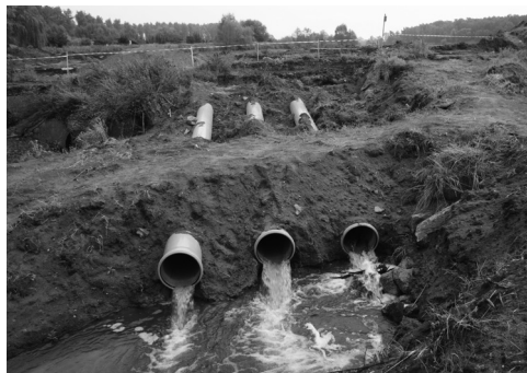
RYSUNEK 5. Tymczasowe rurociągi spustowe o średnicy 400 mm FIGURE 5. Temporary dewatering conduit (400 mm diameter)
