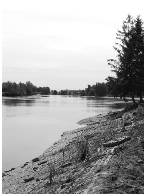
RYSUNEK 3. Uszkodzenia skarpy lewostronnej zapory zbiornika FIGURE 3. Destruction of the left-embankment dam's
