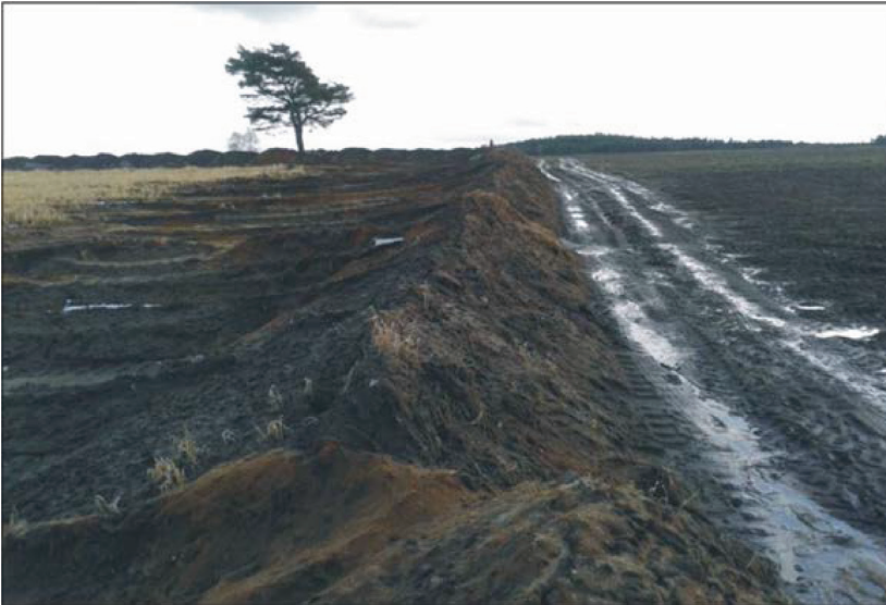
Fotografia 2. Sołectwo Ostrowite; pierwszy etap przygotowywania terenu do eksploatacji: zdejmowanie i zwałowanie warstwy próchnicznej gleby (fot. A. Fiszka Borzyszkowska; 28 września 2014)
