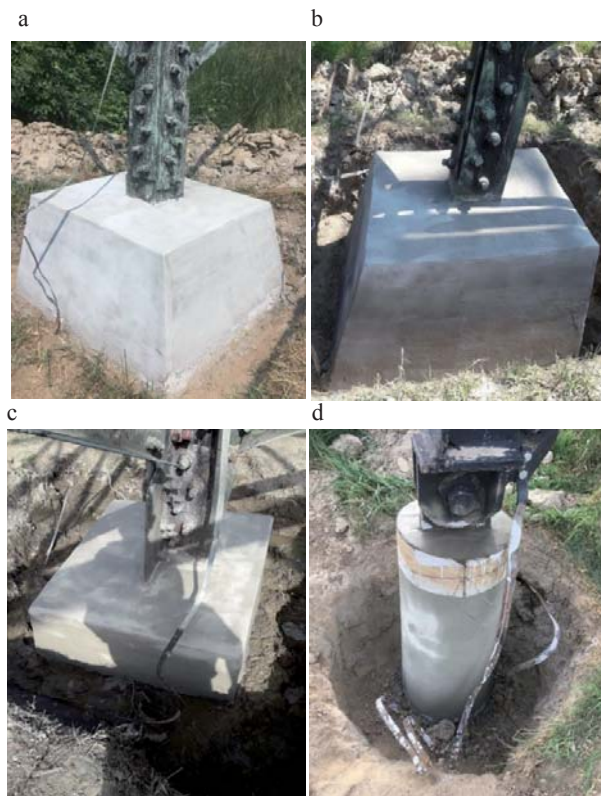
RYSUNEK 4. Fundament z naniesioną warstwą wyrównawczą (a – stanowisko 134; b – stanowisko 123) oraz z naniesioną warstwą zabezpieczającą zbrojenie wraz z warstwą wyrównawczą (c – stanowisko 38; d – stanowisko 108) (fot. A. Brzezińska)
