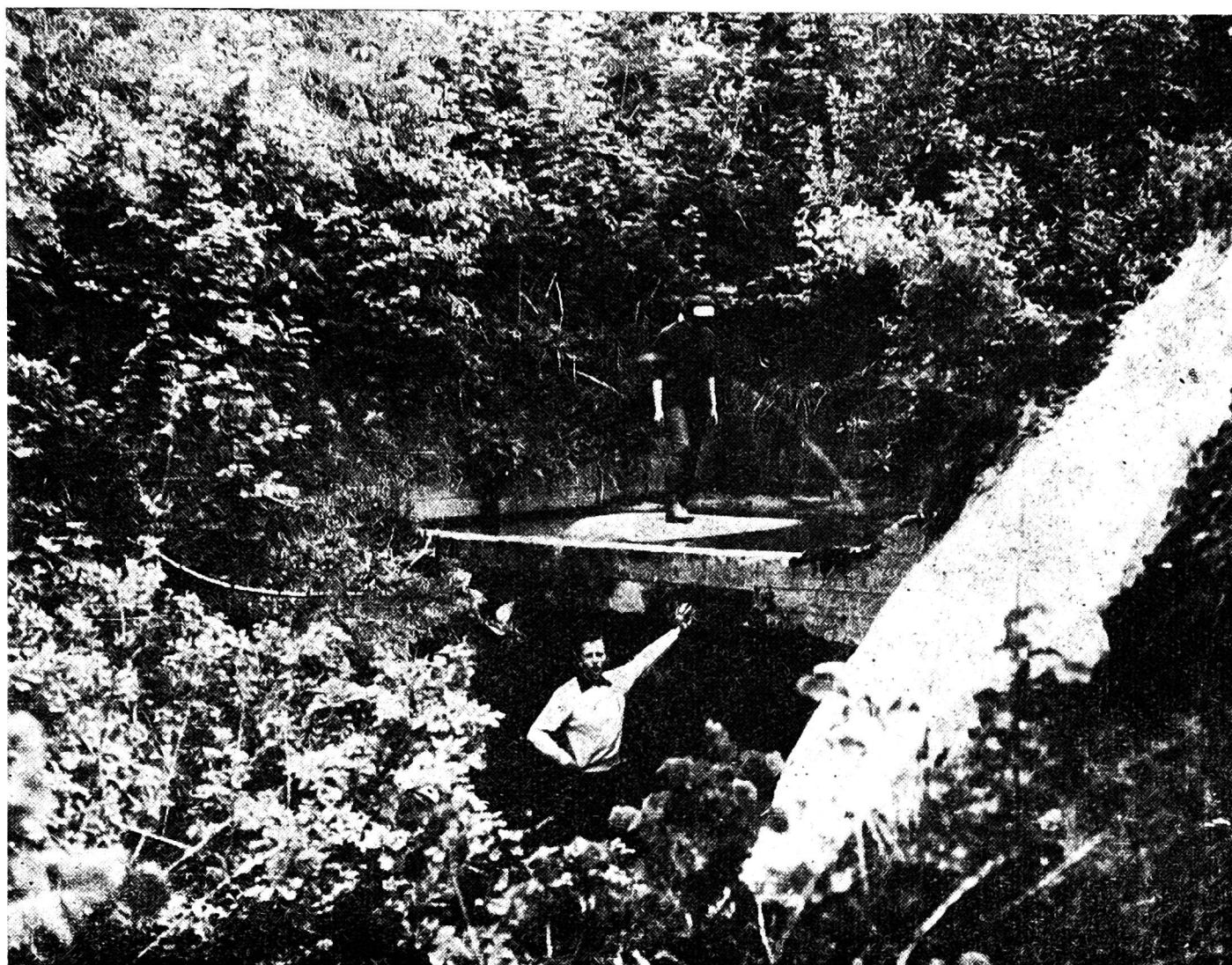
Rys. 7. Podmycie progu żelbetowego widocznego na rys. 6 (w wąwozie bocznym) podczas ulewy w dniu 8. V. 1969 r. 19. V. 1969. Fot. S. Pałys
