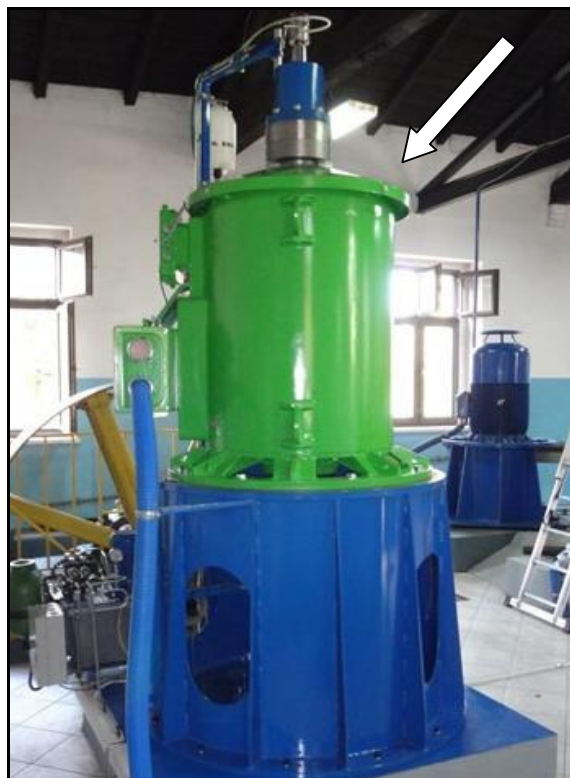
Rys. 16. Bezprzekładniowy zespół prądotwórczy w elektrowni wodnej z generatorem z magnesami trwałymi (kolor zielony – generator)
