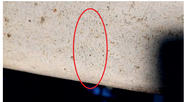
Rys. 14. Wynik prowadzonych inspekcji – stwierdzenie pojawienia się rysy podczas obciążania podkładu [opracowanie własne]
