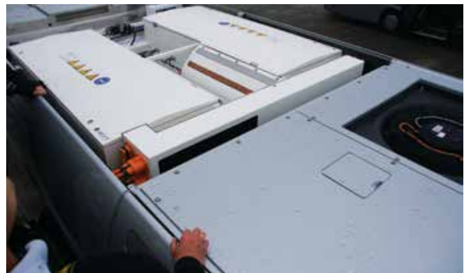
Gniazdo doładowania za pomocą pantografu zamontowane w autobusie Van-Hool Exqui.City
