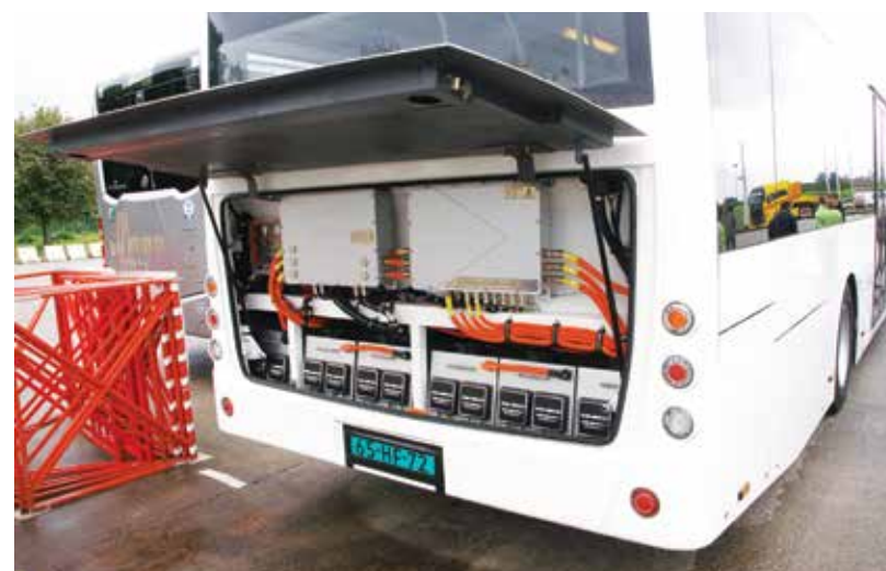
W autobusach elektrycznych, po otwarciu tylnej ściany można zobaczyć jedynie blok baterii i czasami moduł zarządzania energią
