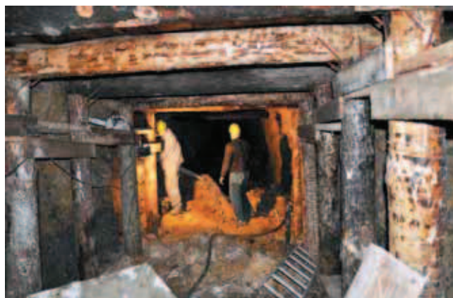
Rys. 2. Prace udostępniające prowadzone przez ekipę górniczą przy adaptacji sztolni będzińskich na podziemną trasę turystyczną
