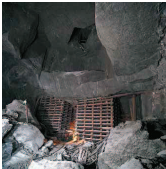
Rys. 5. Komora „Sartory” w KS „Wieliczka” – fragmenty skał opadłych ze stropu wyrobiska Fig. 5. Sartory Cavern in Wieliczka Mine – fragments of rocks fallen from the excavation's roof
