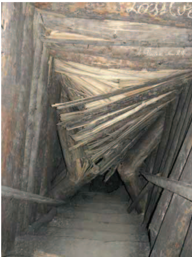
Rys. 1 Zaciskanie obudowy wyrobiska chodnikowego w KS „Wieliczka”
