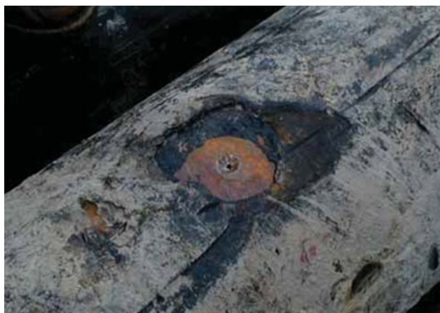
Rys. 2. Typowe uszkodzenie korozyjne wywołane przez prąd błędzący na gazociągu Fot. H. Matus
