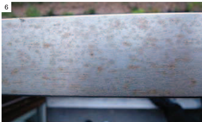
Fot. 5, 6. Liczne przebarwienia i rdzawe plamy powstałe na skutek braku okresowego czyszczenia i pielęgnacji powierzchni elementów balustrad balkonowych wykonanych ze stali gatunku 1.4301
