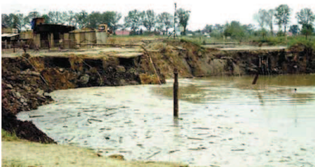
Rys. 22. Zapadlisko nad kawerną solną w Lęzkowicach, XI. 2001 r.
