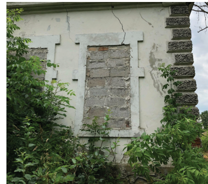
Fot. 3. Ściana wschodnia – pęknięcia i rysy
