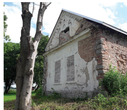
Fot. 5. Elewacja północna z widocznymi ubytkami tynku
