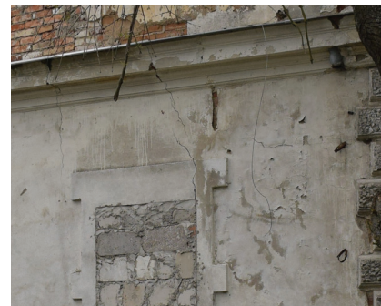
Fot. 4. Ściana południowa – pęknięcia i rysy
