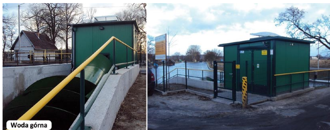
Rys. 7. Stopień wodny Łochowo (turbina Archimedes), Mewat Sp. z o.o. [2, 3]
