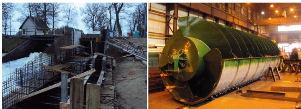
Rys. 6. MEW Łochowo. Etap budowy, produkcja turbiny Archimedes, Mewat Sp. z o.o.; rozwiązanie optymalne w tych warunkach lokalizacyjnych [2, 3]
