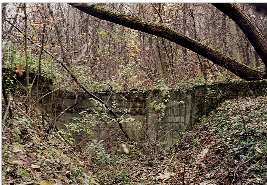
Fot. 7. Stopień skrzynkowy umacniający próg erozyjny w dnie wąwozu, „zespólny” z otoczeniem Photo 7. Box inlet spillway integrated with an environment and used to reinforce the erosion threshold
